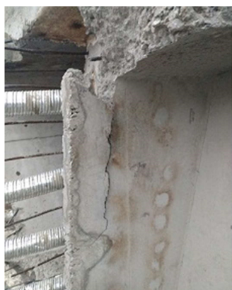
图 3 模板拆除不当和张拉引起的梁端开裂
